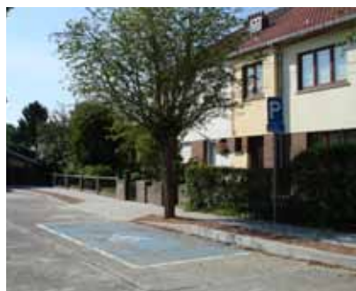
La PMR passagère ne pourra pas sortir aisément du véhicule car le trottoir n'est pas libre de tout obstacle (arbre et revêtement non praticable).
